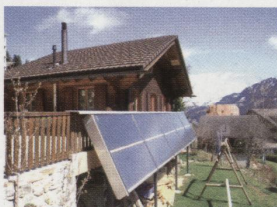
Avec cette installation solaire thermique de 15 m 2 , la famille Bigler a divisé par 4 l'utilisation de sa chaudière à gaz.
